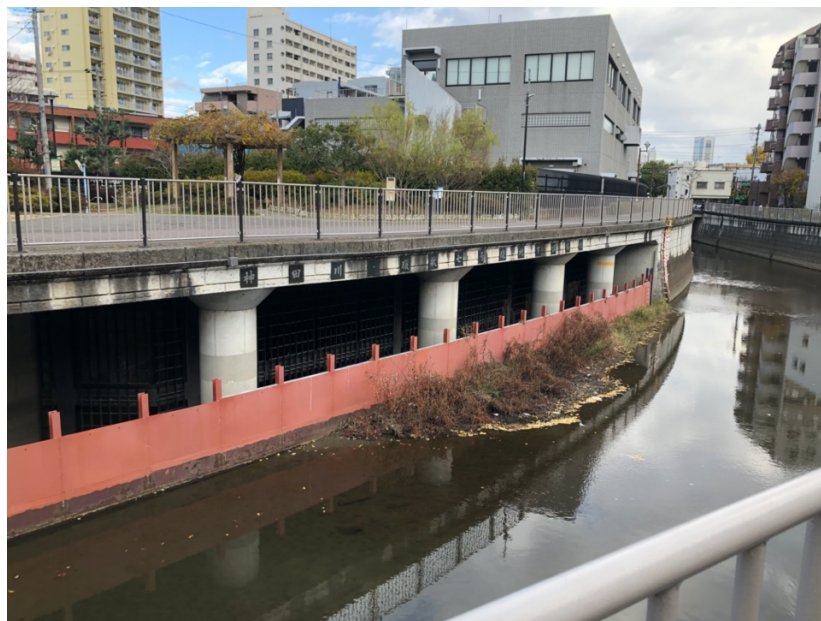
図6：神田川・環状7号線地下調整池の取水部
